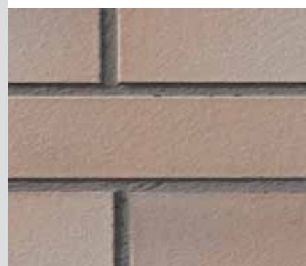
Elmshorn mit dunkler Fuge
